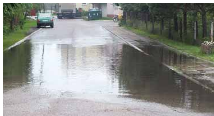
Jak tu dojechać suchą nogą do domu lub sklepu? ul. Szkolna w Czeremsze po opadach deszczu.
